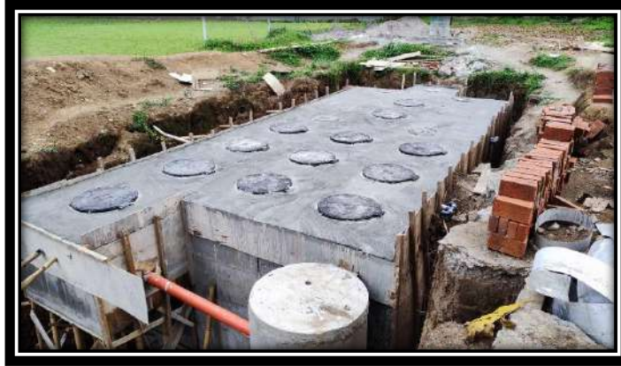
Gambar 3.1 IPAL di Desa Joho, Kecamatan Temanggung
